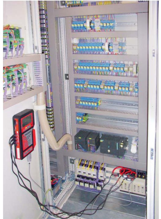
Schaltschrank mit angeschlossenem Energiemessgerät eTracker
