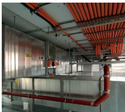
Klare Zuordnung: Verteilerhalle für Zu- und Abluft
